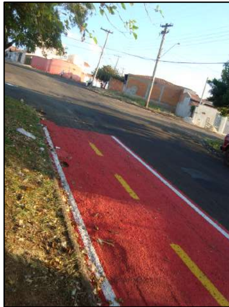
Figura 28: Trecho da ciclovia municipal não finalizado
